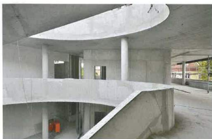
So gut wie neu: Recycling-Beton im Forschungs- und Laborgebäude für Lebenswissenschaften der Berliner Humboldt-Universität. Architekten sind Bodamer Faber aus Stuttgart.
